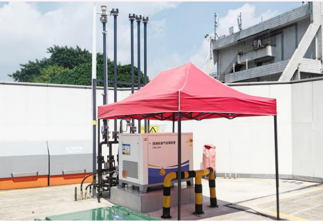
加油站油气处理装置
